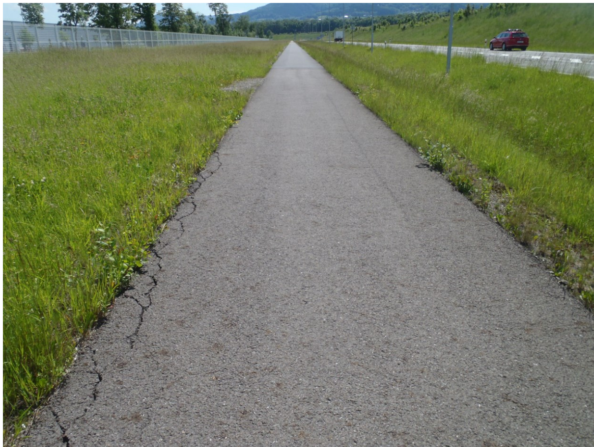
Obrázek 21: Olamování okrajů vozovky
