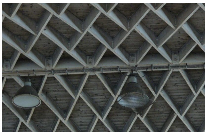
Fig. 2 Detal połączenia lameli dachu hali sportowej
