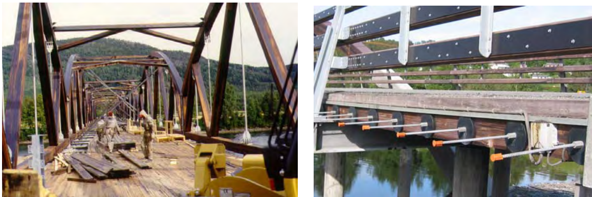
Abb. 15.12 Verlegung der Fahrbahnplatte der Evenstad-Brücke (Photo: Moelven Limtre) und Detail der Måsør-Brücke (Photo: K. Bell)
